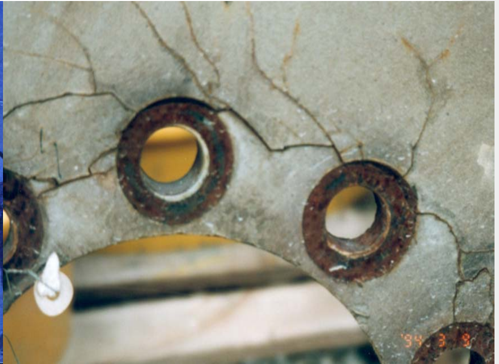
Disco central fisurado
